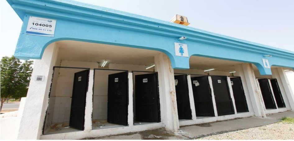
شكل رقم (١): عدم فصل دورات مياه النساء عن الرجال
