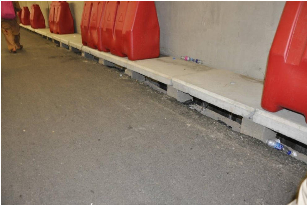
شكل رقم ١٩ : صورة فوتوغرافية توضّح الفتحات الجانبية للطريق لسحب مياه المطر في الطريق من نفق الملك خالد بالعزيمية الجنوبية والمؤدي لمنطقة جمرات الدور الثاني (طريق أتوبيس النقل الجماعي) .
