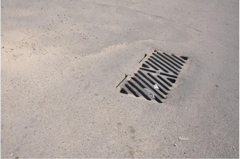
شكل رقم ١٥: صورة فوتوغرافية توضح فتحات الصرف المؤدية لمصارف السيول تحت السطحية.
